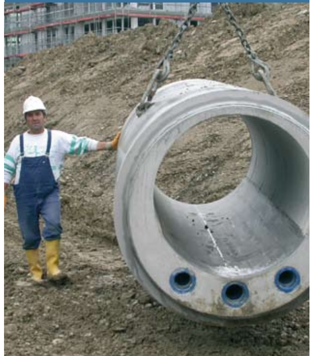
Mittels eines Kanalwärmetauschers wird der Kanalisation Wärme entzogen. (Foto: Uhrig)
