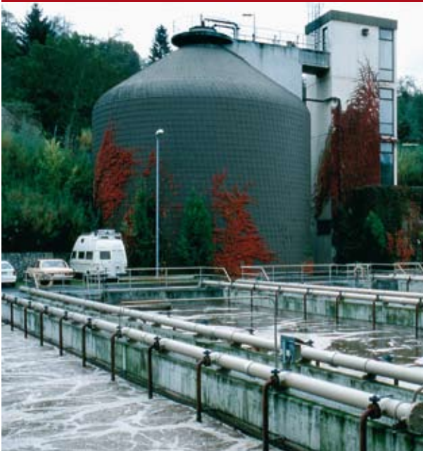
Die Kläranlage Waiblingen produziert Ökowärme und Ökostrom.
