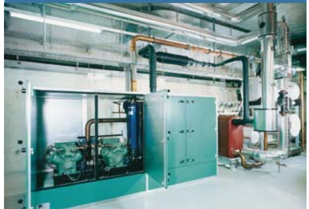
Aus 12-gradigem Abwasser wird 60-gradiges Heizwasser: Die Technik der Wärmepumpe macht es möglich. (Foto: Morf)
