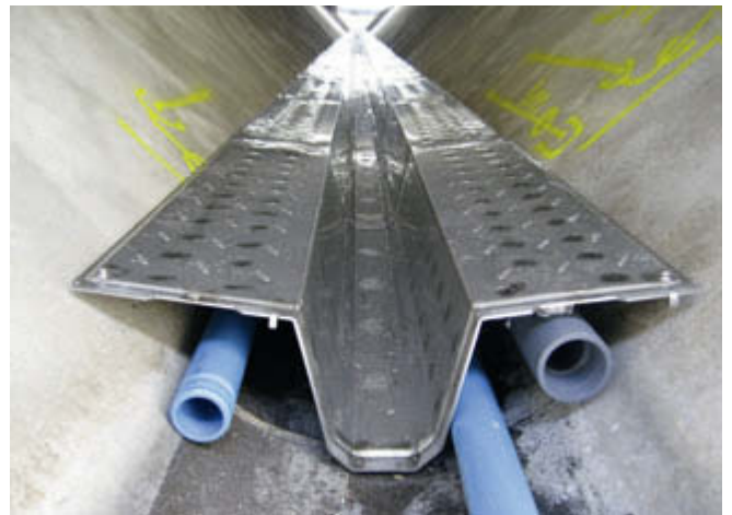
Abb. 3: Wärmetauscher-elemente (Firma Uhrig) während der Installation in der Schlangennrinne (Drachprofil) (Foto: Jan Butz, Klinger und Partner)
