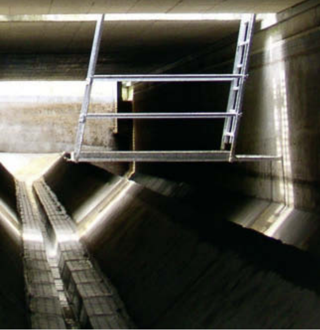
Abb. 4: Absenkbares Besucherpodest über den Wärmetauschern im Regenüberlaufbecken Saarstraße in Bretten (Foto: Hubert Mauz, Uurig Kanaltechnik)
