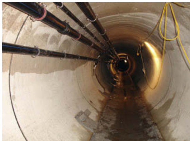
Abb. 4: Blick in einen Kanal mit neu eingebauten Wärmetauschern beim Objekt in Bonnstetten im Kanton Zürich (Quelle: KASAG, Langnau)
