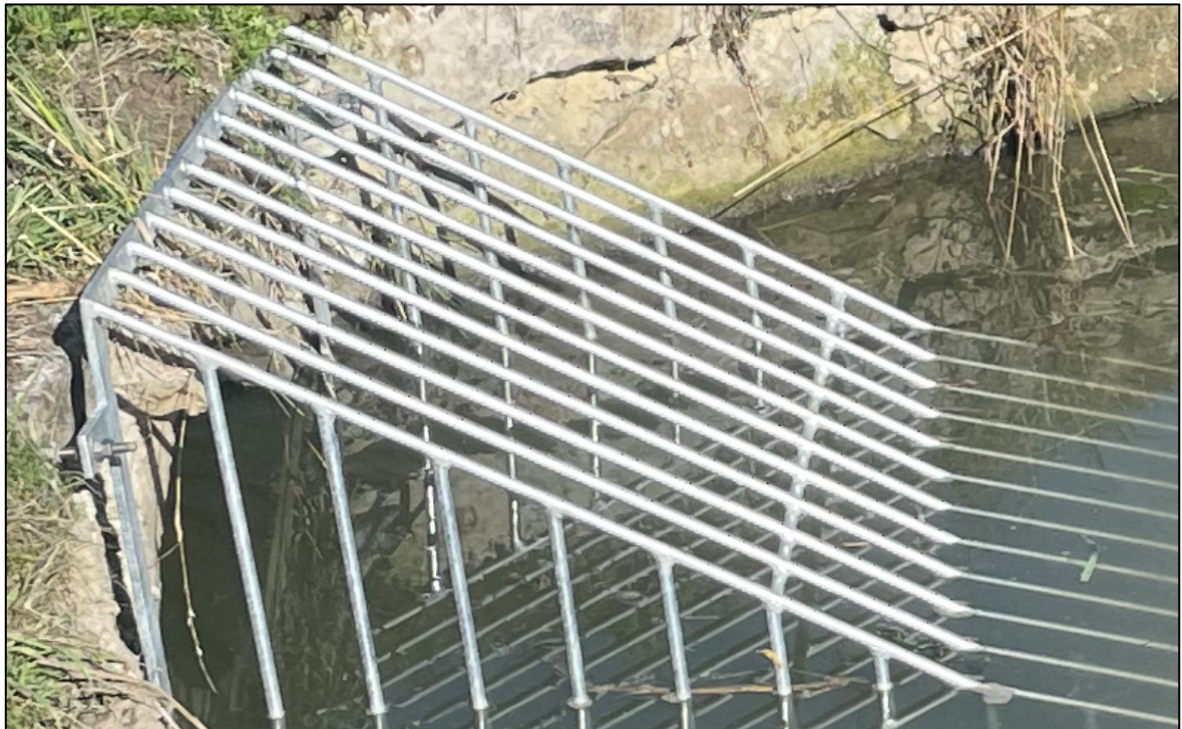
Abb. 1: Eingebauter Schrägrechen an einer Verdolung. © Timo Wesner
