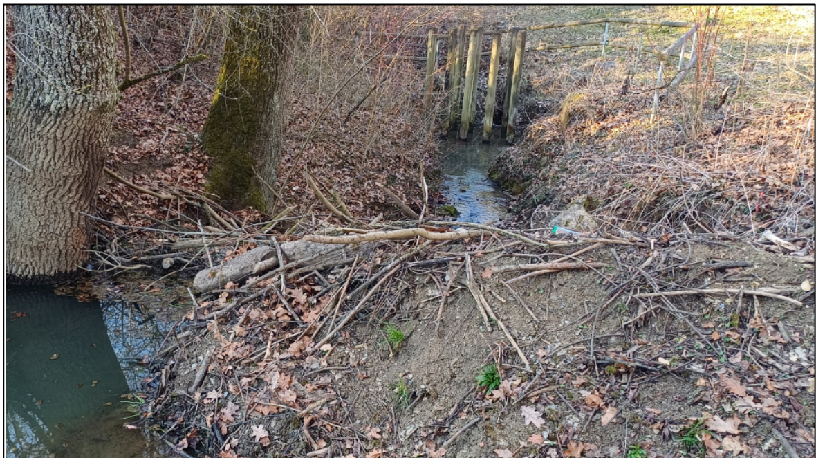
Abb. 2: Biberdamm in unmittelbarer Nähe zu einem Rohrdurchlass unter einer Straße. Dieser wurde mittels vertikalem Rechen aus Holz (im Hintergrund) gegen ein Verklausen geschützt. Im Vergleich zu Schrägrechen, besteht hier jedoch ein größerer Wartungsaufwand. © Nils Reiser
