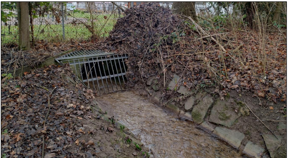
Abb. 6: Räumlicher Rechen an einer Dole. © Timo Skorzak
