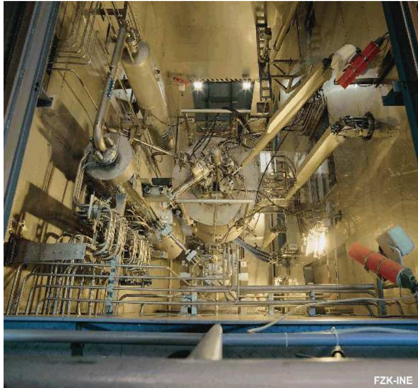
Abbildung 3-1: Blick in die Verglasungszelle der Pilotverglasungseinrichtung im Forschungszentrum Karlsruhe
