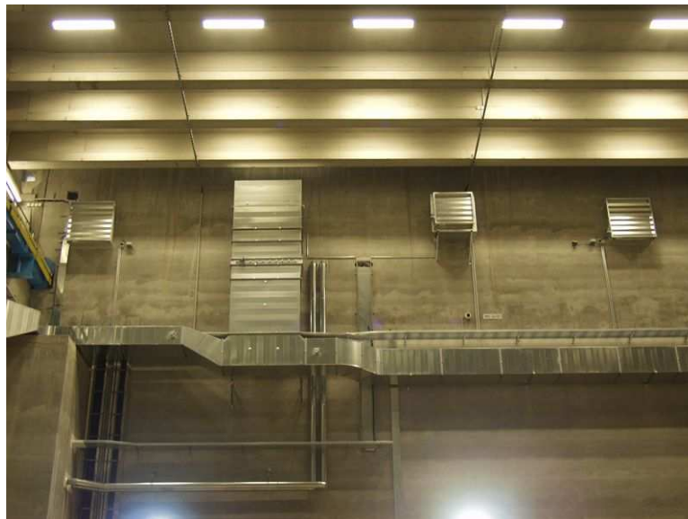
Abbildung 3-3: Lüftungskanäle im Zwischenlager
