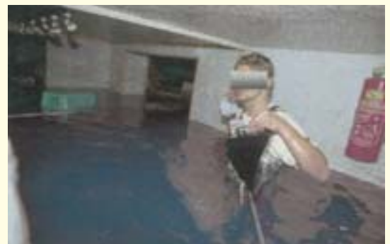
Ausgelaufenes Heizöl im Keller eines Wohnhauses
