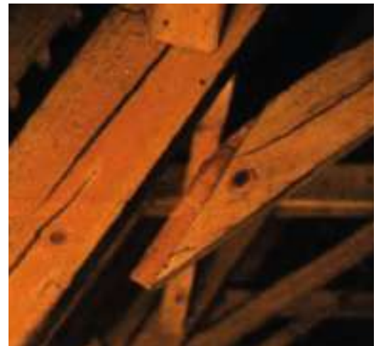
Abb. 15 Versagen eines nicht gegen Zug gesicherten Holzanschlusses
