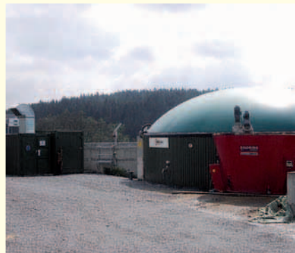
Behälter und BHKW
