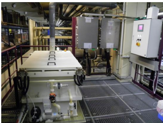
Reaktor mit Gleichrichter und Schaltschrank
