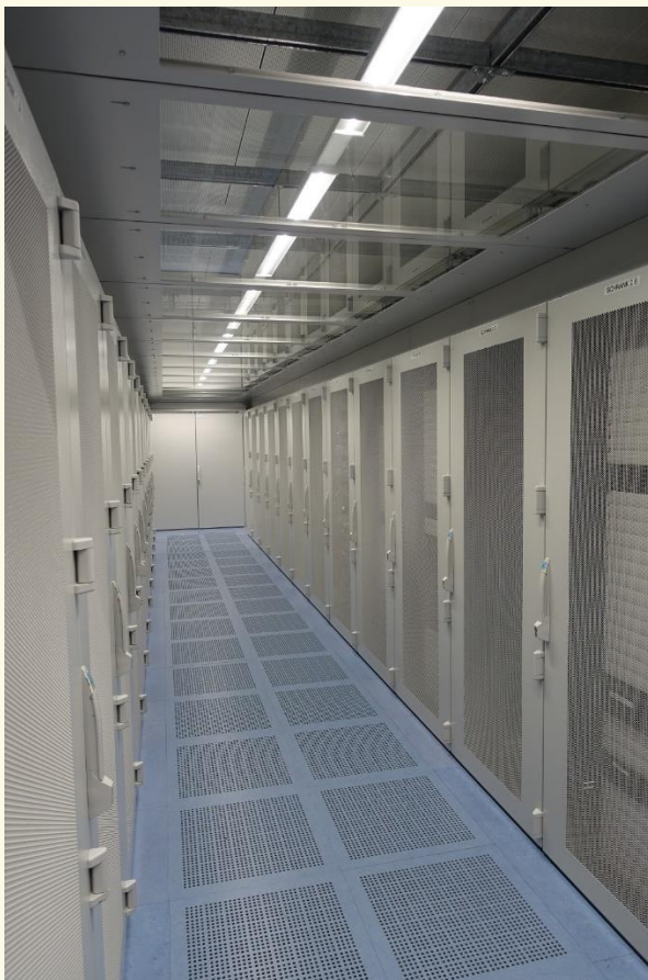
Abbildung 1. Eingehauster Kaltgang bei der BITBW 4
