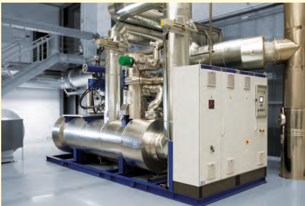
ABB. 12: ORC-ANLAGE IN BIETIGHEIM-BISSINGEN (DÜRR CYPLAN LTD. 2015)
